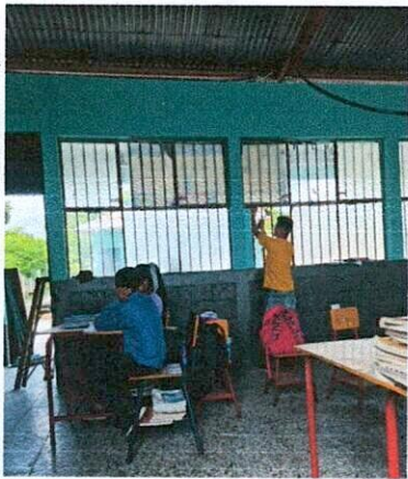
Foto 7: Corte, reparación, pintura de puertas, pintura de balcones y cambio de algunos vidrios
